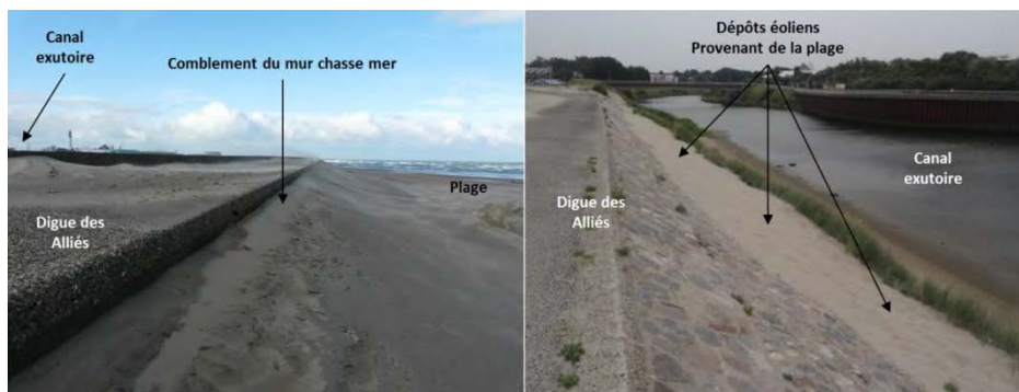
Figure 6. Photographies illustrant les dépôts éoliens de part et d'autre de l'ouvrage.
