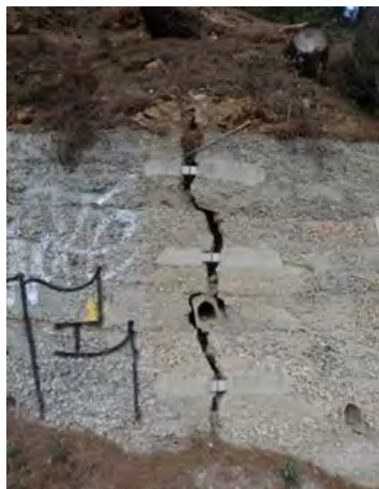
Figure 6. Barre témoin de fissure en 2016.
