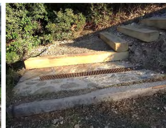
Figure 4. Renvoi d'eau ajouté dans l'emmarchement.
