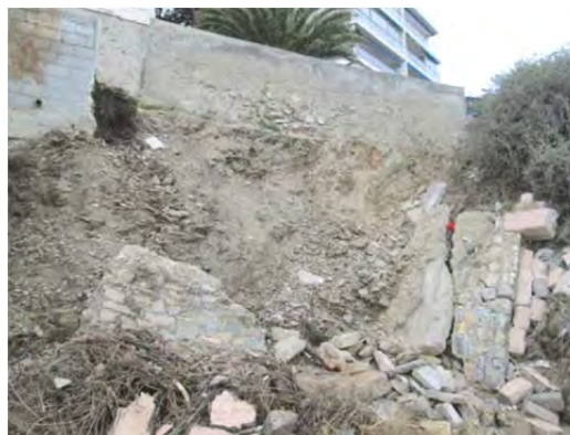
Figure 16. Glissement et écroulement vus de la plage.
