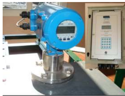
c- De gauche à droite : marégraphe côtier numérique et centrale d'acquisition (depuis 1992)
